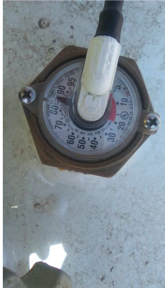
Dial Tanques de 250gal a 1000gal
